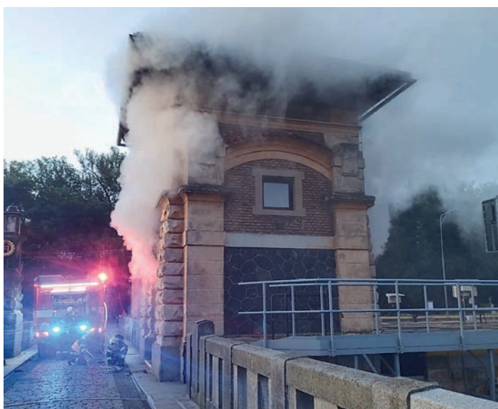
Požár velínu plavební komory Hořín
