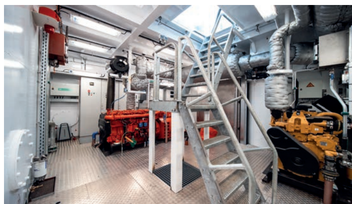
Strojovna servisního plavidla
