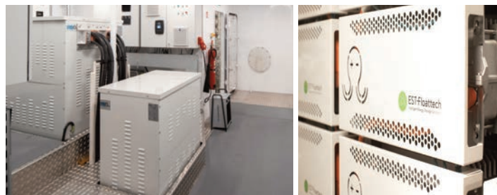
Hlavní akumulátory a výkonová elektronika servisní lodě
