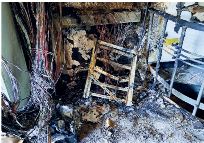
Následky požáru v přízemí velínu
