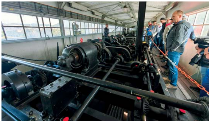
Exkurze ve strojovně VD Střekov
