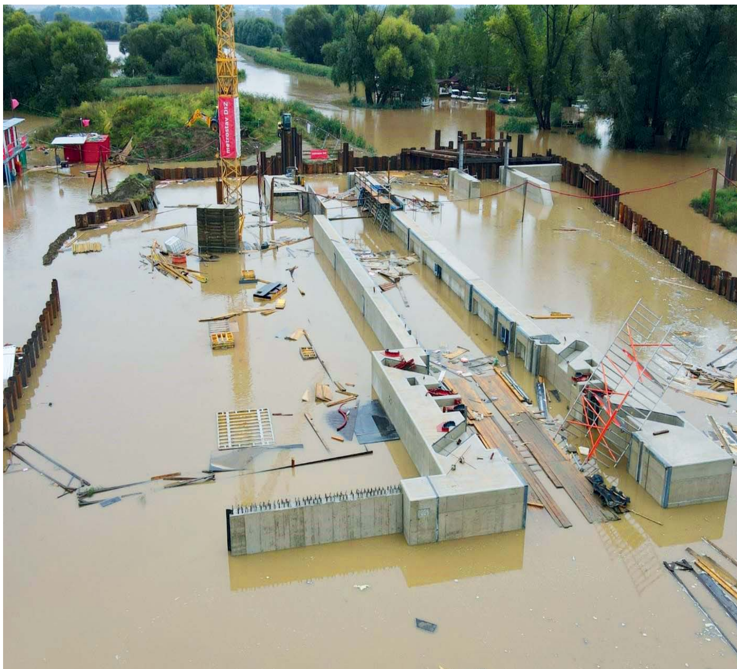
Zaplavená jímka při povodni 09/2024 (zdroj: Metrostav DIZ s.r.o.)
